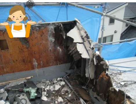
バルコニー笠木周りからの漏水で 外壁が腐っていた 補修費用約200万円かかりました
