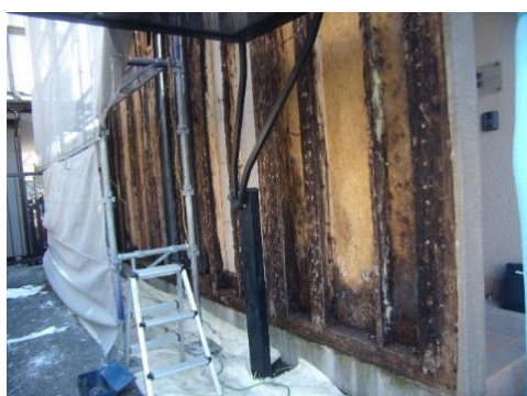
外壁と屋根周りから雨漏り！補修 費用約250万円かかりました
